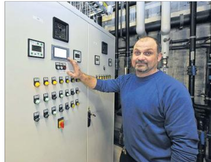
HERZSTÜCK Betriebsleiter Beat Brack vor der Schaltzentrale, dem Herzstück des Hallenbads Telli; sie wurde im letzten Jahr ersetzt.
