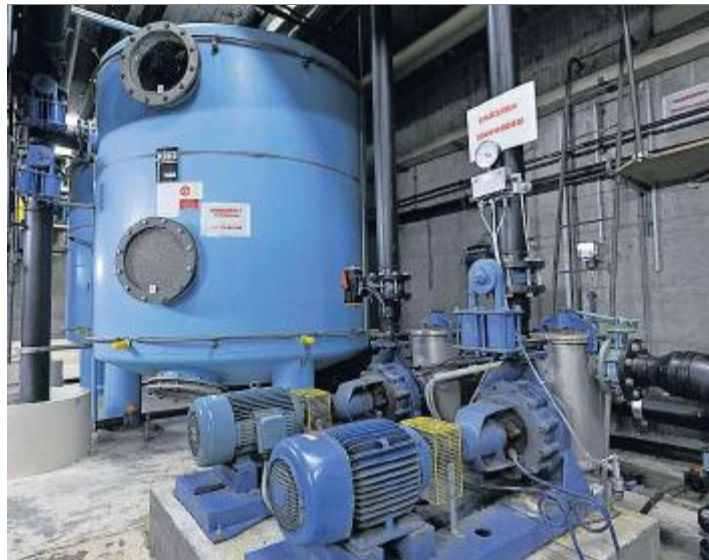
FILTER UND PUMPEN Einmal pro Woche wird das gesamte Wasser durch die Drucksandfilter (hinten) gepumpt. Vorne die alten Pumpen.
